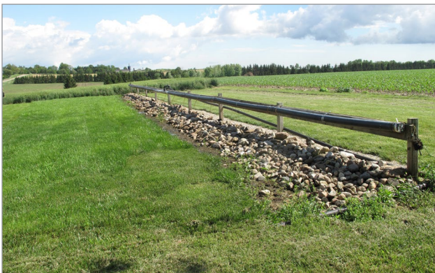
Figure 2. Un tuyau collecteur avec des trous uniformément espacés (pour distribuer le liquide sur toute la largeur d'un système de bandes de végétation filtrantes) dans le comté de Middlesex. La base en gravier réduit le risque d'érosion du sol au début des bandes de végétation.
