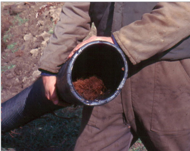
Figure 4. Grosse section de tuyau bouchée par les racines d'un saule imposant situé à 30 m de distance. Il faut déterrer la section bouchée et la remplacer. (Source de la photo : Office de protection de la nature de la région de Long Point, Ontario)
