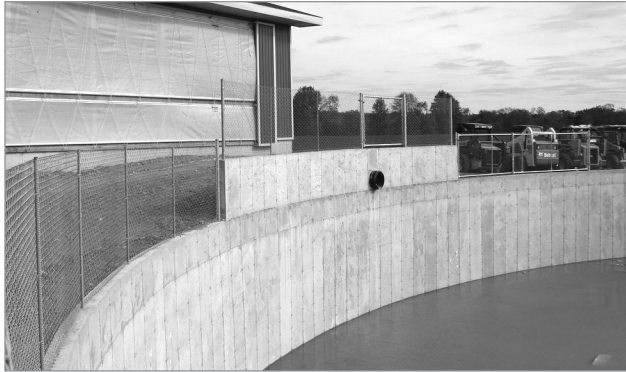
Figure 1. Vue d'une structure de stockage en béton entourée d'une clôture de protection à mailles losangées de 1,5 m (5 pi) de haut.
