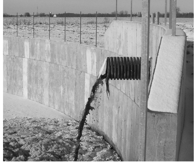
Figure 2. Système de transfert par gravité déversant les éléments nutritifs liquides par-dessus le mur d'un réservoir. Photo : Dietrich Engineering Limited
