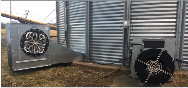
Figure 8. Ce silo utilisé pour le séchage des grains à l'air ambiant est pourvu de deux ventilateurs : un ventilateur centrifuge à basse vitesse (à gauche) et un ventilateur centrifuge en ligne (à droite), dont le but est d'améliorer le débit d'air et d'accélérer ainsi le séchage.
