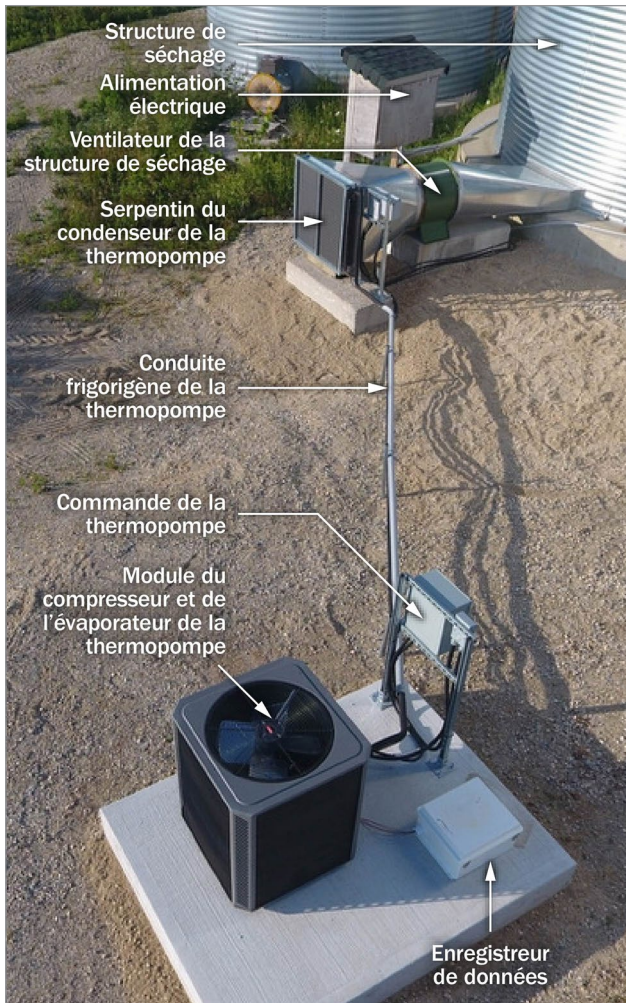
Figure 5. Le système de séchage des grains avec thermopompe illustré ici offre un coefficient de performance (COP) de 6,93. Source : APS Dineen Farms, Kenilworth, Ontario.
