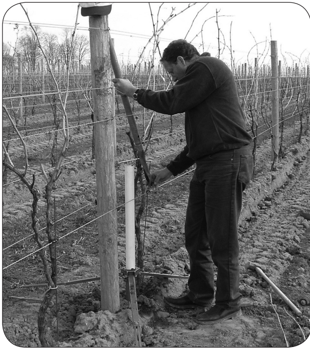
Figure 1. Installation d'une conduite d'accès à un instrument de surveillance de l'humidité du sol. Photo de : WeatherINnovations Inc.
