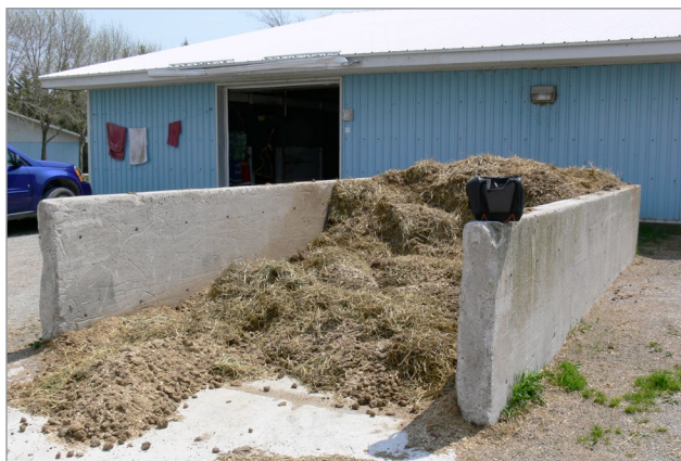
Figure 9. Avec ses parois de béton armé, cette structure de stockage de fumier de cheval de 3 m x 6 m x 1 m de hauteur (10 pi x 20 pi x 3,25 pi) permet à une chargeuse de comprimer le fumier en se servant des parois comme butoirs.
