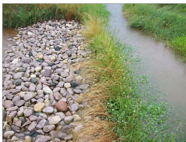
Figure 5. Déversoir d'urgence enroché entre la zone de décantation et la voie d'écoulement herbacée.
