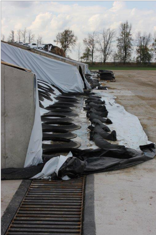
Figure 7. Tranchée de collecte d'effluents à l'avant d'un silo-couloir plein; seuls les effluents peuvent pénétrer dans la tranchée.
