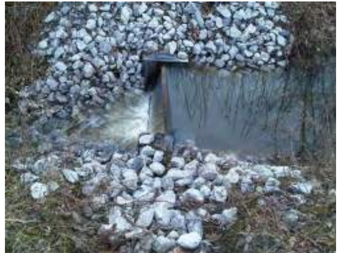
Figure B4-10. Structure de contrôle de l'eau (barrage). Source : Dietrich Engineering Limited, Waterloo, Ontario
