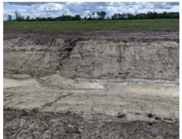
Figure B4-6. Érosion du sol causée par le fait que la couverture végétale n'a pas été maintenue (sol dénudé).
