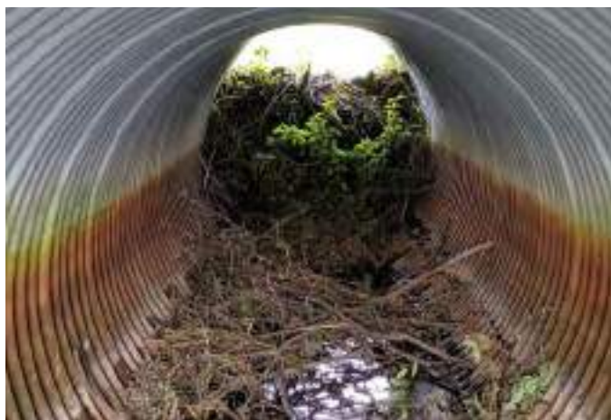
Figure A3-21. Barrage de castors construit sur le côté en amont d'un ponceau.
