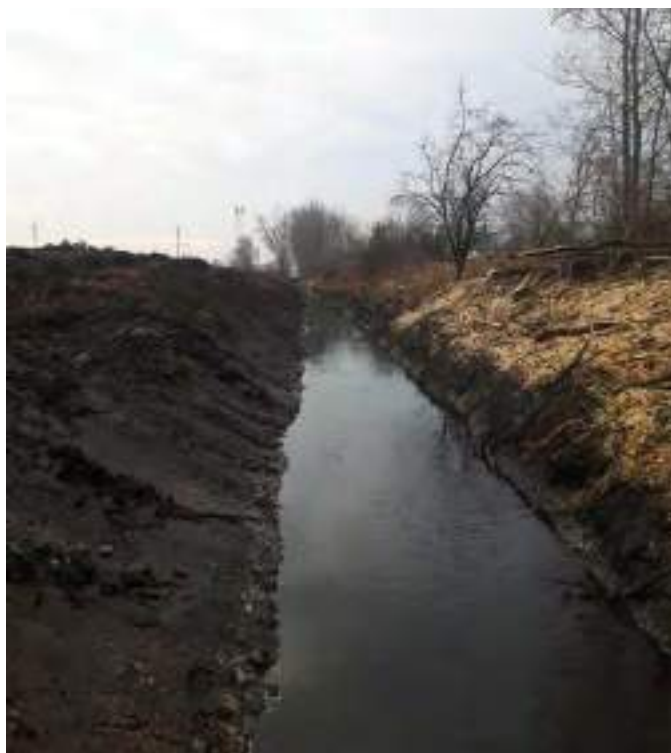
Figure A3-13. Nettoyage complet d'un drain effectué récemment.
