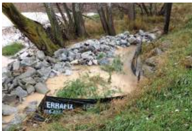
Figure B4-8. Eau turbide dans un drain due à l'érosion.
