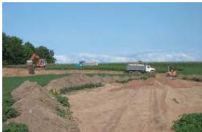
Figure A2-4. Dommages causés à un champ de soja à la suite de la construction d'un drain.
