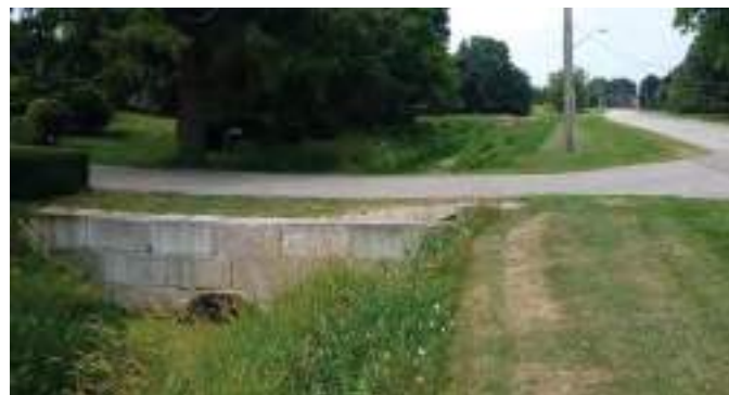
Figure A3-25. Passage d'accès au-dessus d'un drain. Source : Municipalité de Chatham-Kent, Ontario
