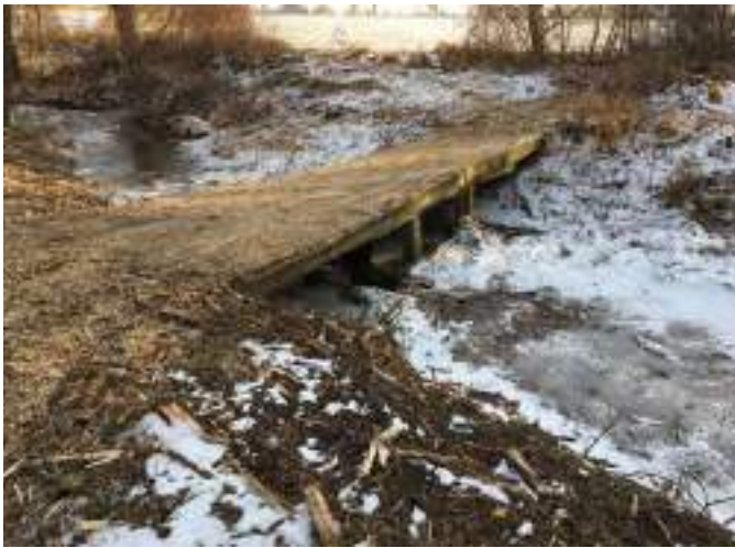
Figure A4-3. Pont bas au-dessus d'un drain qui pourrait causer une obstruction.
