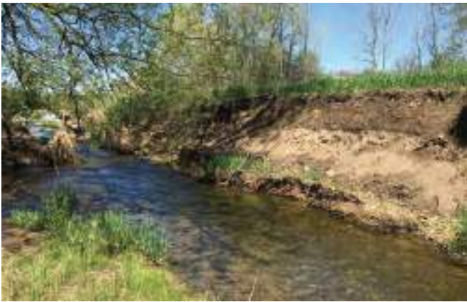
Figure B4-2. Défaillance de la berge le long d’un drain. Source : Dietrich Engineering Ltd., Kitchener, Ontario
