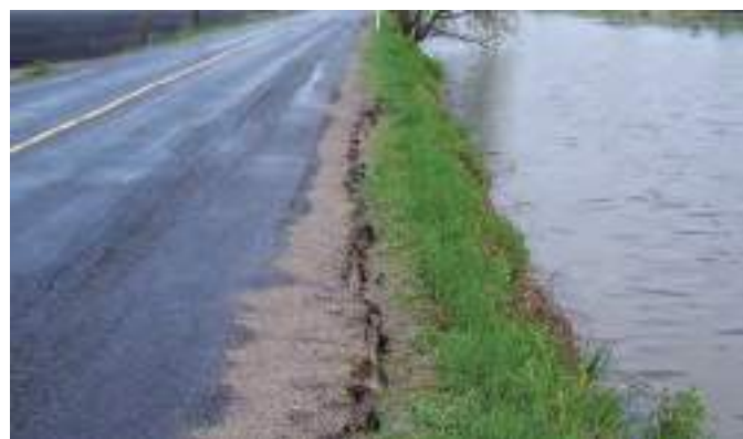
Figure A5-1. Enquête identifiant un drain endommagé en bordure d'une route.
