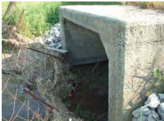
Figure A2-12. Clôture d'une ferme obstruant un drain.
