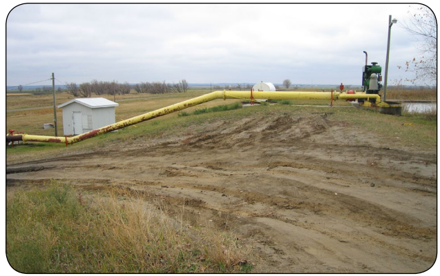
Figure 8. Les conduites de remplissage et de vidange du réservoir doivent être placées par-dessus les bermes (et elles ne doivent pas les traverser).
