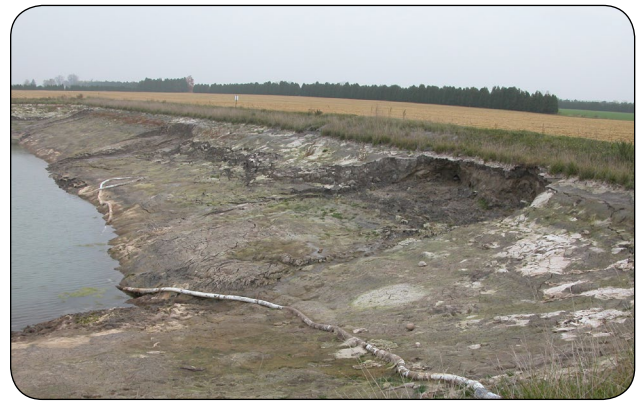
Figure 16. Glissement et effondrement de la rive intérieure d'un réservoir.
