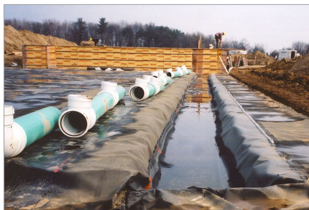
Figure 4. Sections de tuyaux en PVC prêts pour l'assemblage. Les tuyaux formeront un système sûr de transfert de fumier liquide depuis le réservoir situé dans le futur bâtiment d'élevage jusqu'à la structure extérieure d'entreposage du fumier.
