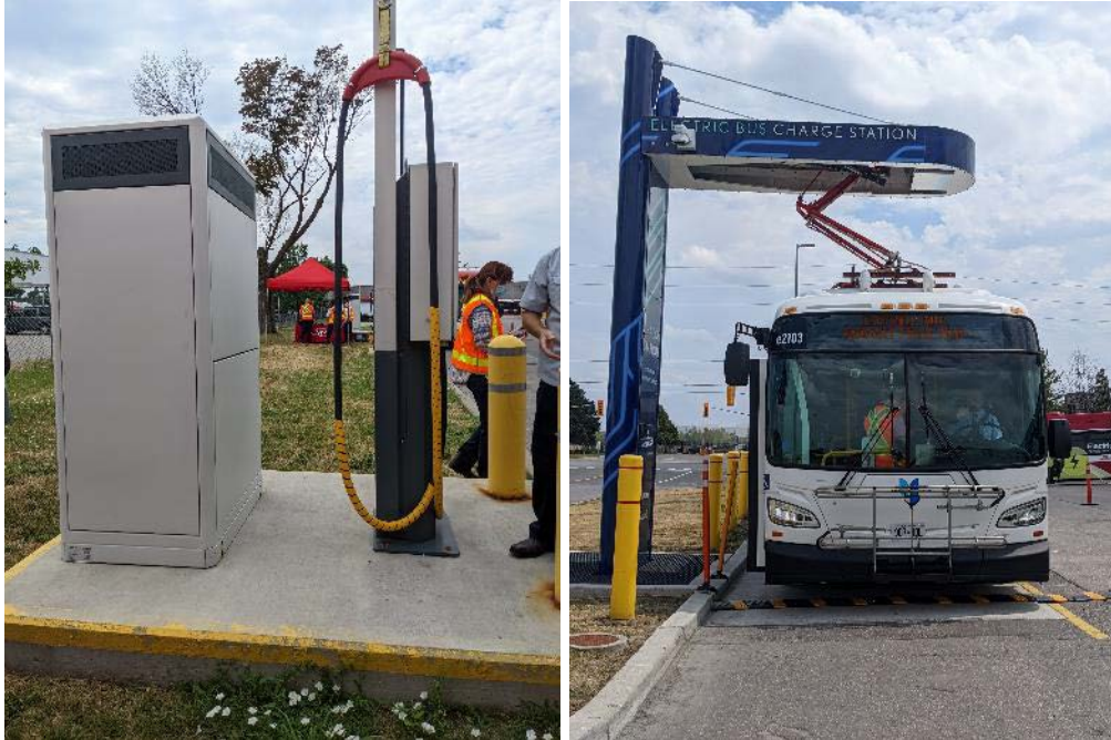
FIGURE 24 : STATION DE RECHARGE DES BATTERIES DE VÉHICULES ÉLECTRIQUES AU DÉPÔT (À GAUCHE) ET STATION DE RECHARGE AVEC PANTOGRAPHE (À DROITE)
