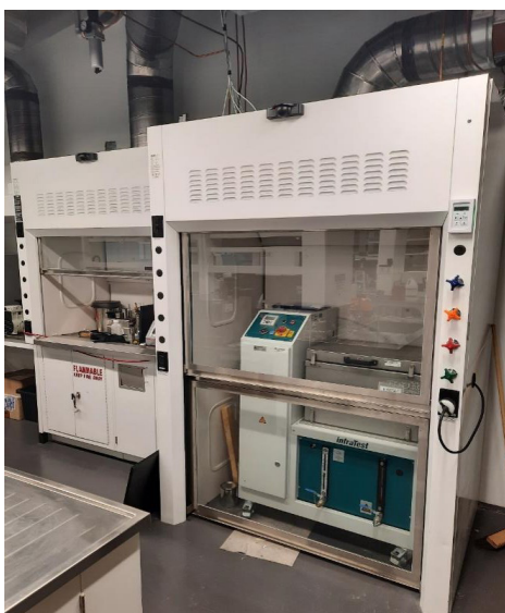
Hotte protégeant le personnel des fumées et des vapeurs produites par les gros appareils. Le châssis de la hotte va du plancher au plafond. L'équipement est utilisé à l'intérieur.
